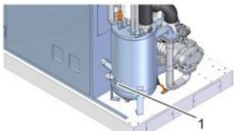
Рис. 31: Проверка уровня охлаждающей жидкости через смотровое стекло
